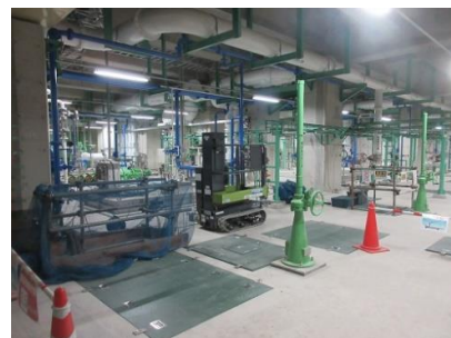
(写真14) 新しい施設、攪拌室
