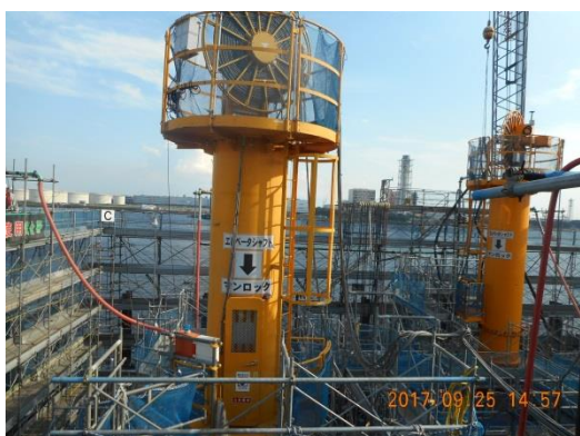
マンロック（作業員が出入りするエレベーター付き）
