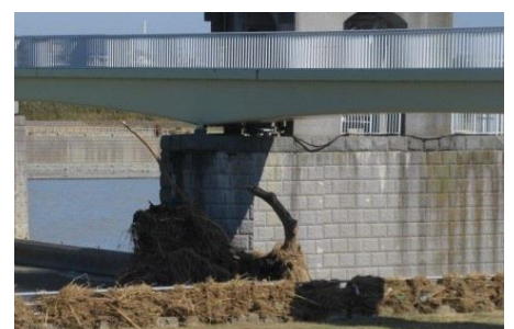
写真13 橋脚の下に引っかかった樹木
